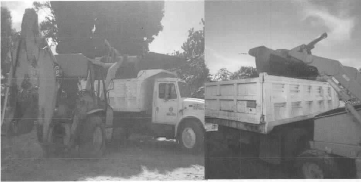
RECOLECCION DE LODOS EN AREAS AFECTADAS POR INUNDACION.
